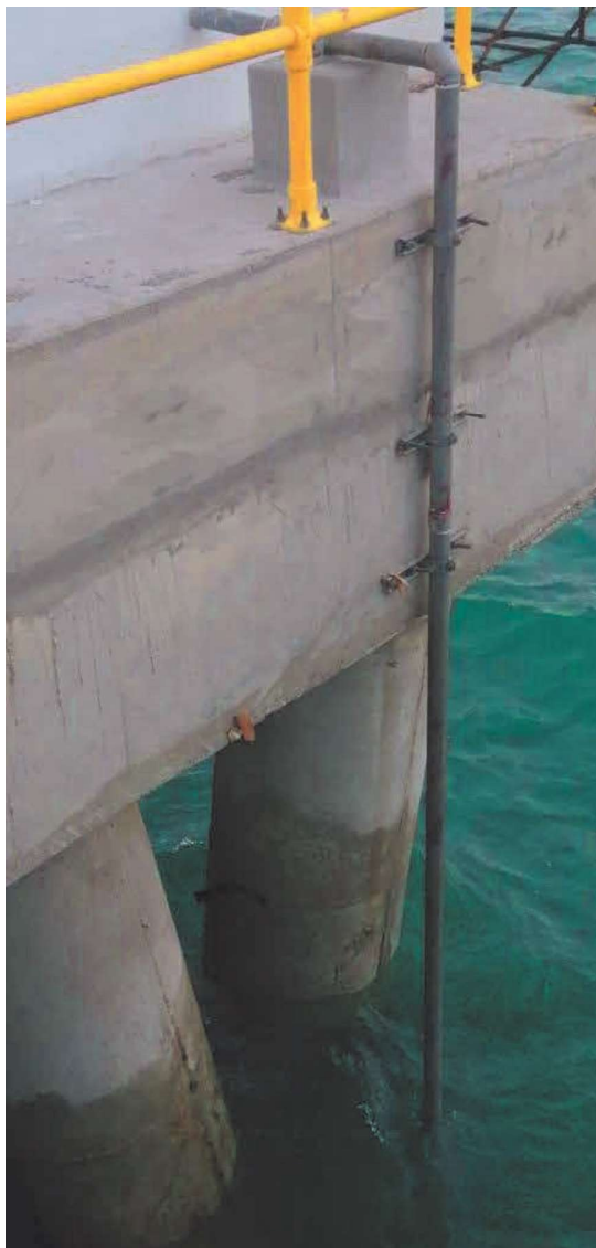
SISTEMA DE AGUA SALADA EN MUELLE
